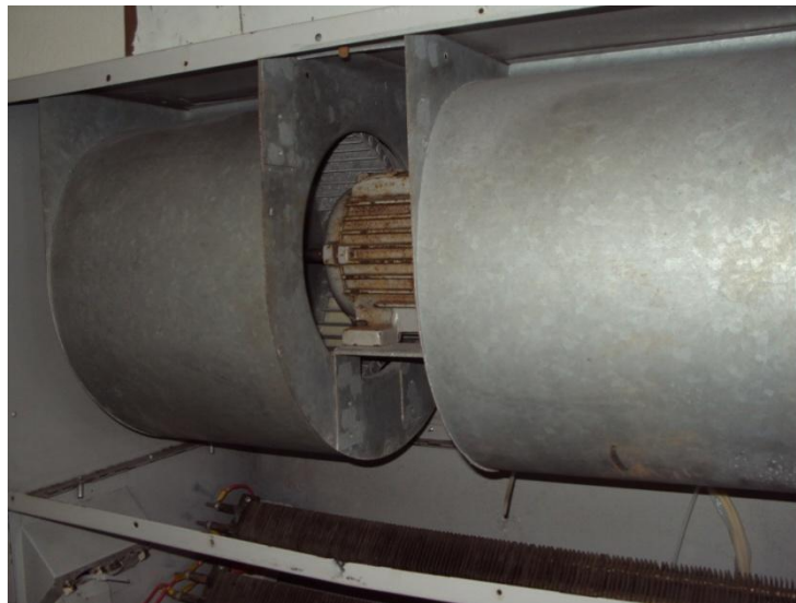
Figura 4 – Ventiladores usados no módulo de insuflamento do sistema
