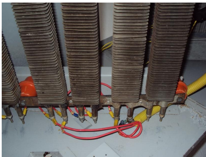
Figura 2 – Resistências elétricas usadas no módulo de aquecimento do sistema
