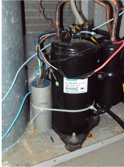
Figura 3 – Sistema de refrigeração usado no módulo de resfriamento do sistema
