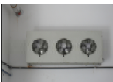
Ventiladores câmara fria
